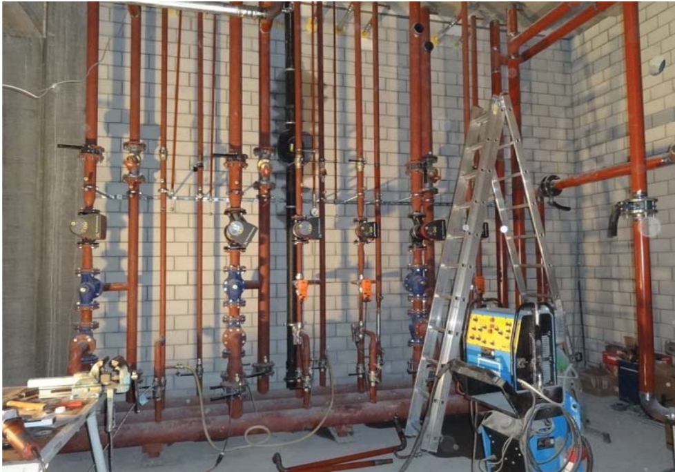
Heizverteiler mit Heizgruppen-Aufbauten
