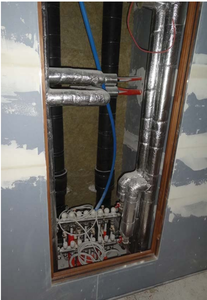
Zugänglicher Schacht mit Installationen
