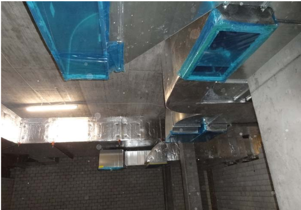
Offene Lüftungsinstallation sind vor Verschmutzung geschützt
