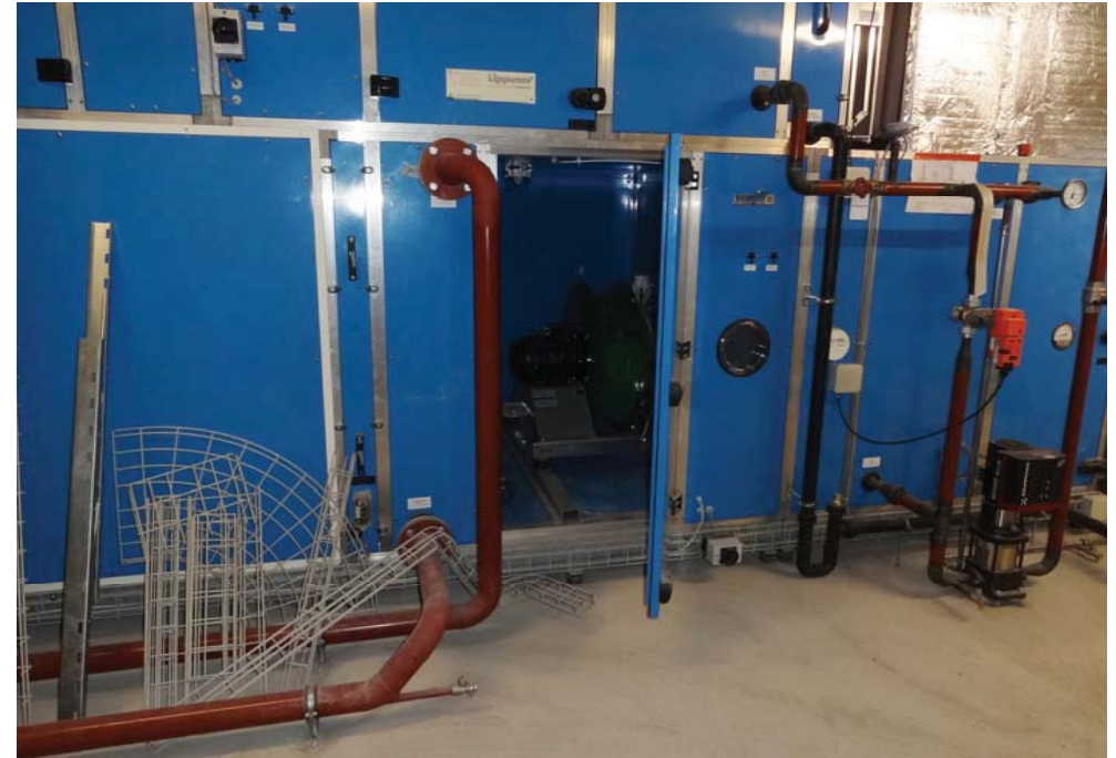
Lüftungsmonoblock mit Anschlussinstallationen - gut zugänglich
