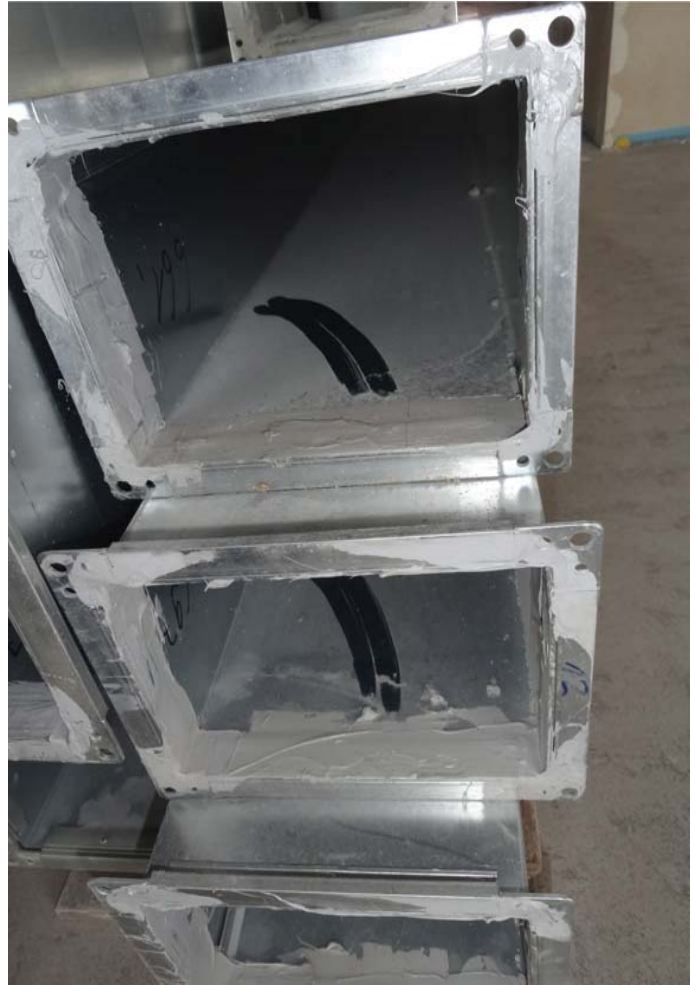
Ungeschützte und verschmutzte Lüftungskanäle
