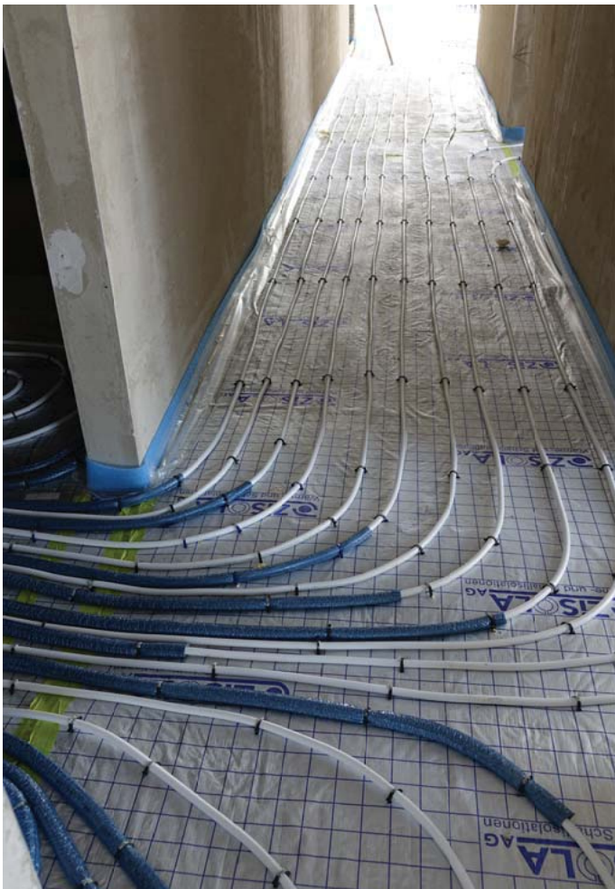
Bodenheizung mit Dämmungen bei Austritt
