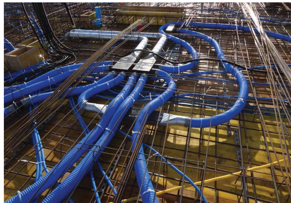
Lüftungseinlagen mit korrekt ausgeführten Kreuzungen
