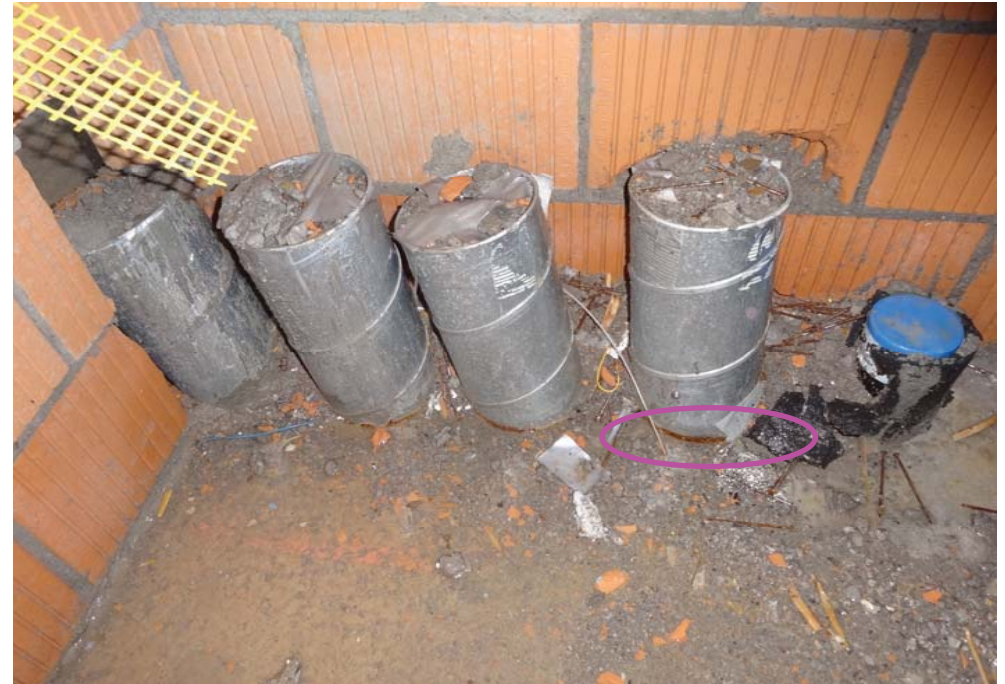
Lüftungseinlagen ausserhalb der Decke - geschützt oder korrodiert
