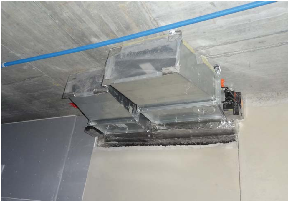
Korrektter Einbau Brandschutzklappen - Zugänglichkeit gewährleisten
