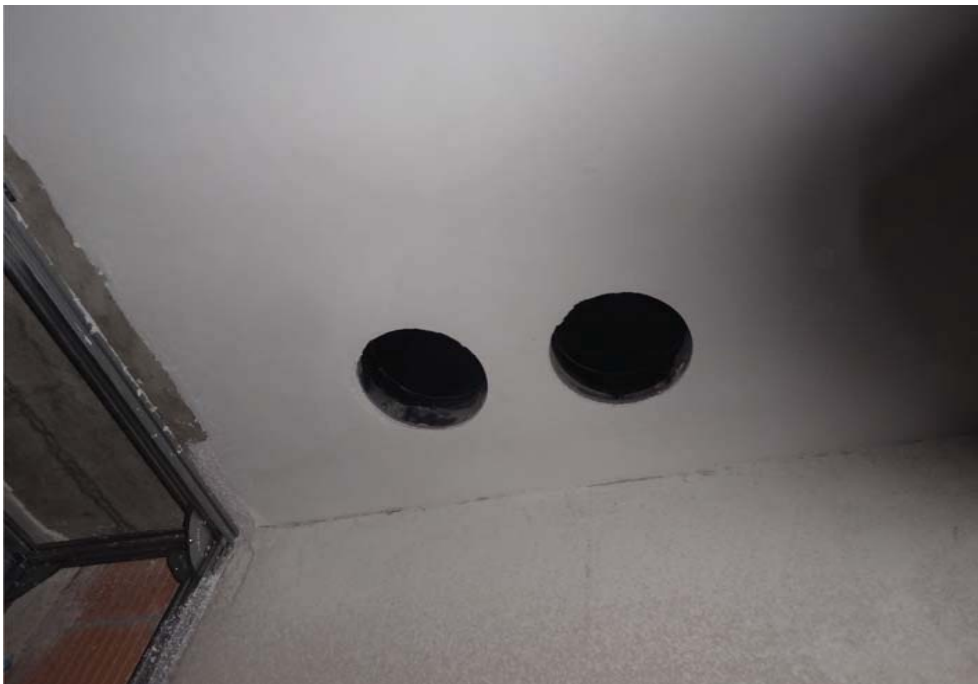
Offene Lüftungsanschlüsse an Decke - Gefahr von Verschmutzung
