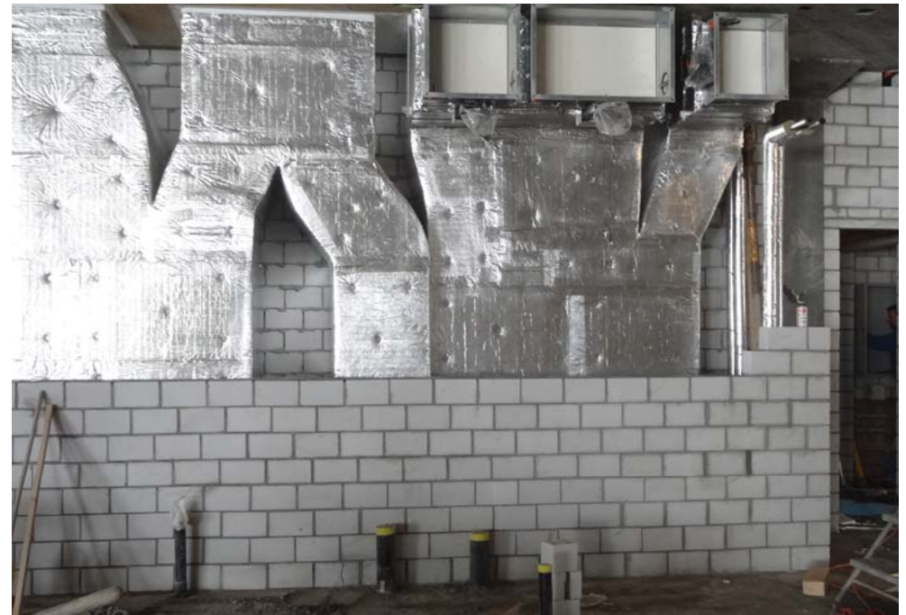
Strömungstechnisch einwandfreie Lüftungsinstallation
