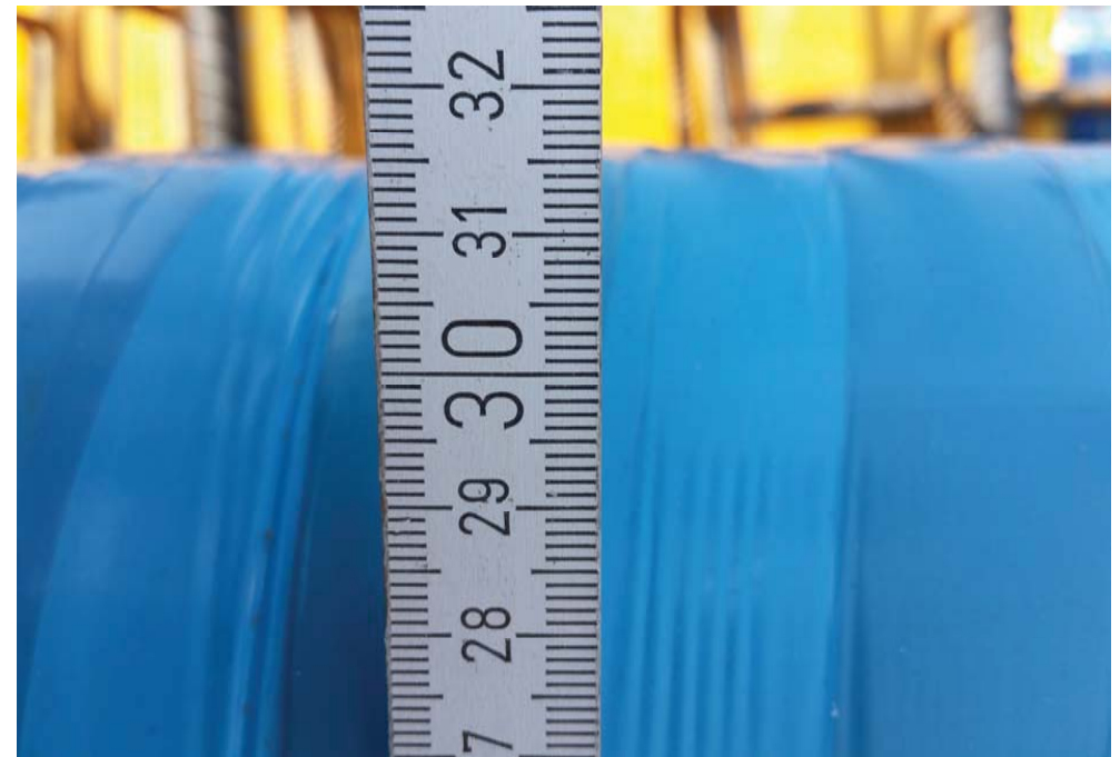
genügende Überdeckung mit Beton nicht gewährleistet
