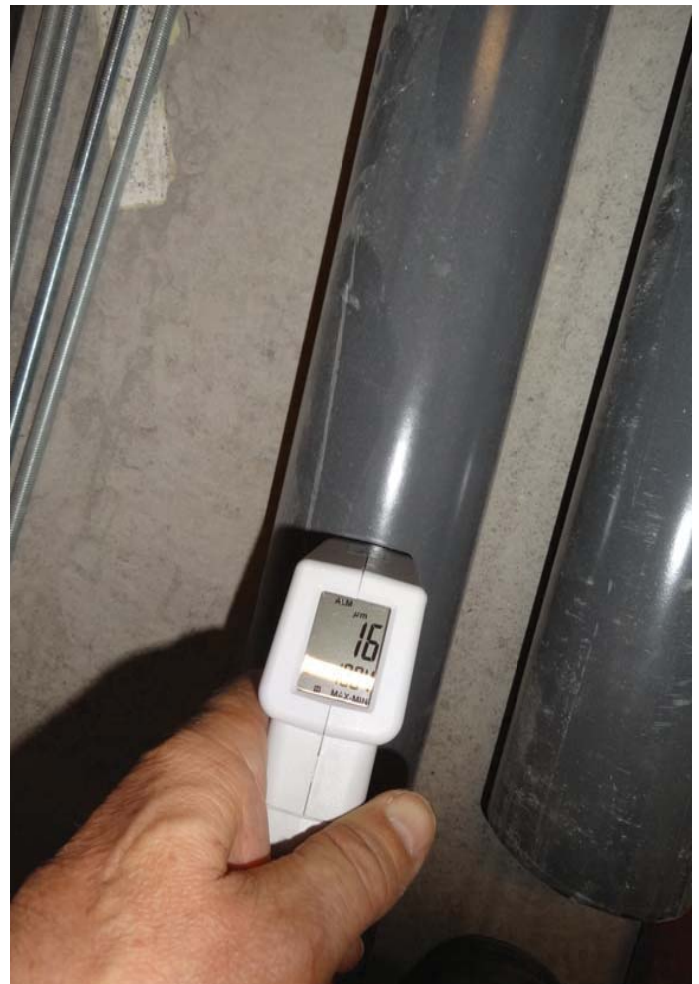
Schichtdickenmessung Kälteleitung - ungenügend
