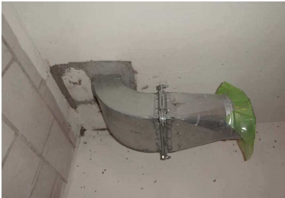
Aussenluftkanal eingemauert - mangelnder Schall - und Kondensationsschutz
